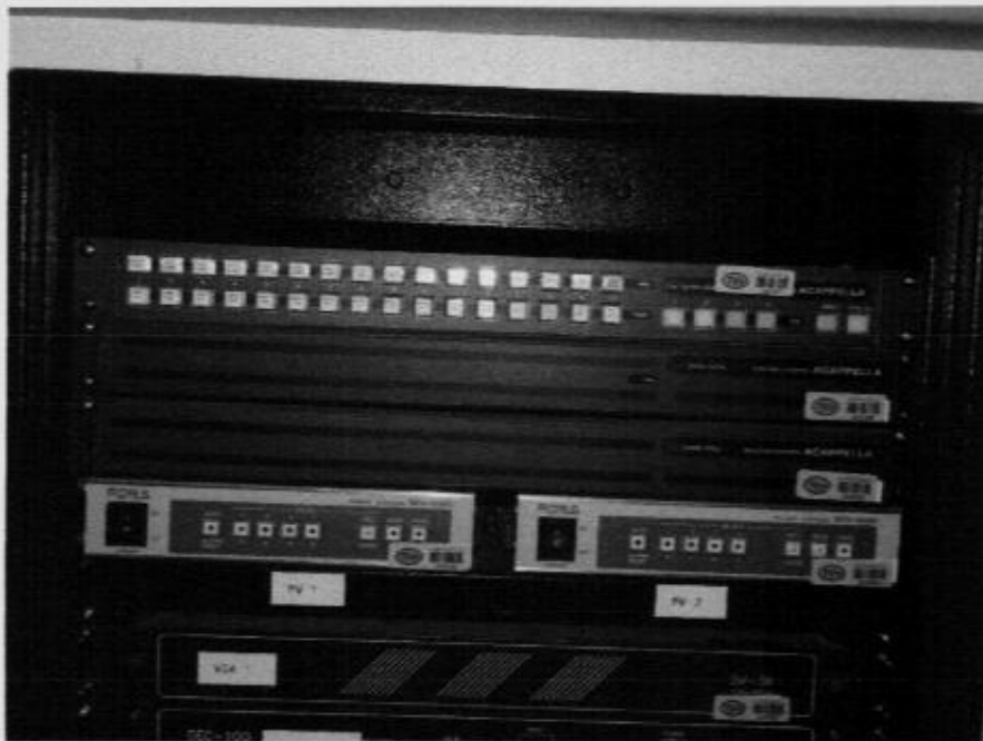
Vista do roteador de sistema “GrassValley-Acapella”
